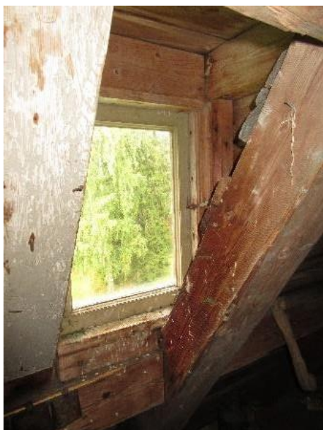
Bild 32. Fågelspillning och små spår av regnvatten kring taklykta.
