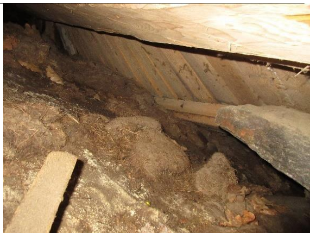
Bild 29. Golvkonstruktionen har ställvis rasat ner i kryptrunden under "ravintola".
