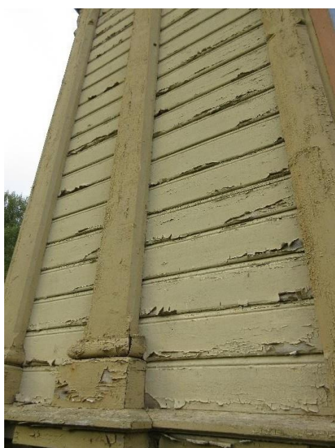
Bild 9. Färg flagar på fasaden.
