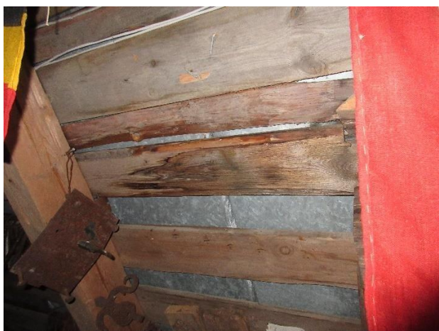
Bild 34. Våning 3. Spår av fukt kring taklykta.
