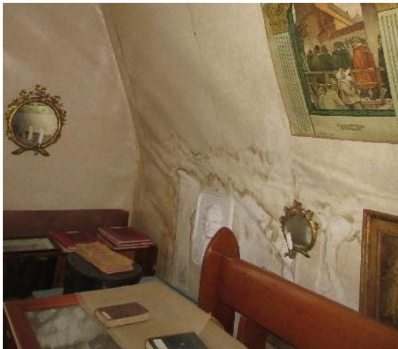
Bild 55. Vån. 2. Spår av fukt på vägg, eventuellt på grund av tidigare takläckage, se bild 4.
