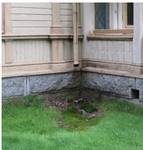
Bild 10. Ingen regnvattenavledning. Stuprör mynnar vid stenfot, vilket ökar fuktbelastningen på konstruktionerna och gör att takvatten kan söka sig in i till krypgrunden under byggnaden.
