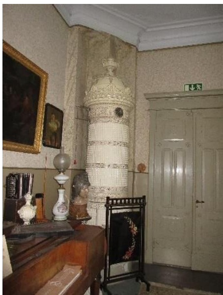
Bild 49. Kabinetti 1. Spår av fukt kring mur.
