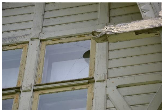
Bild 15. Exempel på söndrigt fönster, förekom på några ställen.
