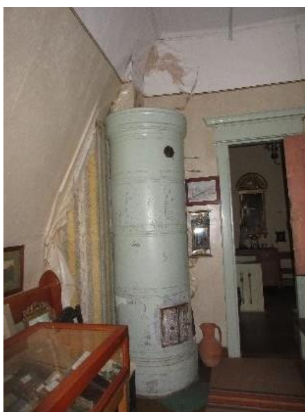
Bild 54. Spår av fukt kring mur, våning 2.
