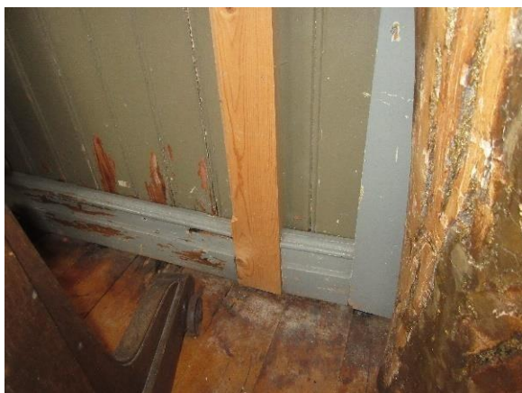
Bild 40. Glasverandan, spår av fuktinträningar utifrån, troligen samband med bild 6.
