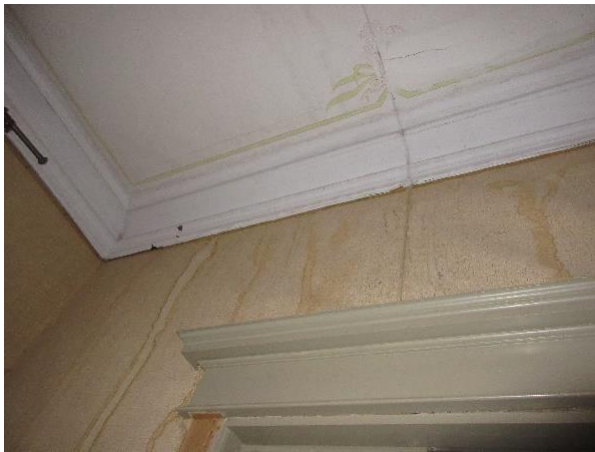
Bild 45. Spår av fukt ovanför dörr i kabinetti 1. Kan eventuellt komma från takläckage.
