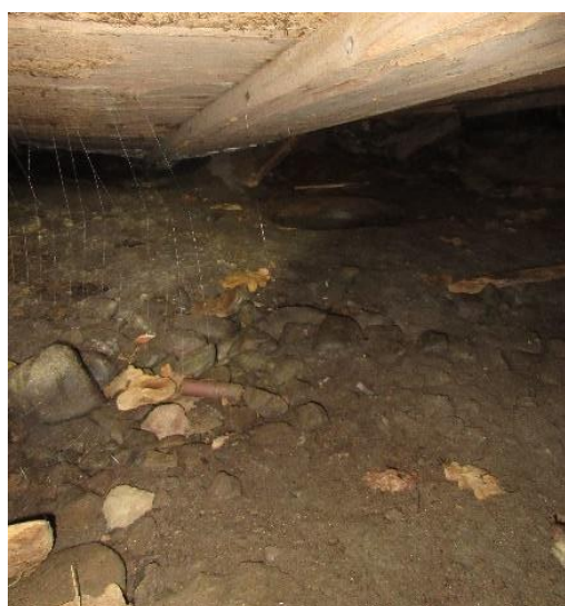
Bild 28. Krypgrunden under "kabinetti 1". Fuktigt, marknivån ställvis hög, golvkonstruktionen har ställvis rasat ner i kryptrunden.
