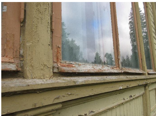
Bild 7. Fönsterkarmar i varierande skick. Målfärg flagar på både fönsterkarmar och vägg.
