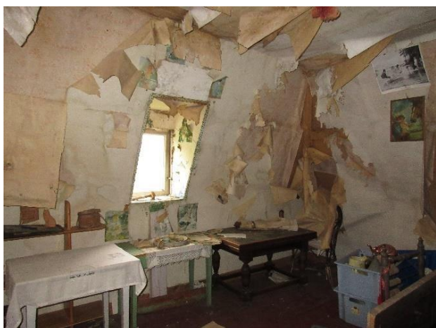
Bild 33. Våning 3, rum i den norra ändan. Tapeten lossnar från väggarna, troligen på grund av rå luft och fukt när byggnaden är ouppvärmad.
