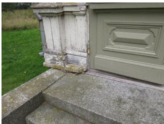
Bild 12. Tröskelplåt saknas, risk för fuktrinrängningar. Tröskelplåt saknas på samtliga ytterdörrar. Träfasad ner mot trappa, ökad skaderisk.
