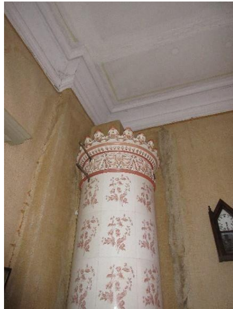
Bild 46. Kabinetti 1. Fuktspår kring mur.
