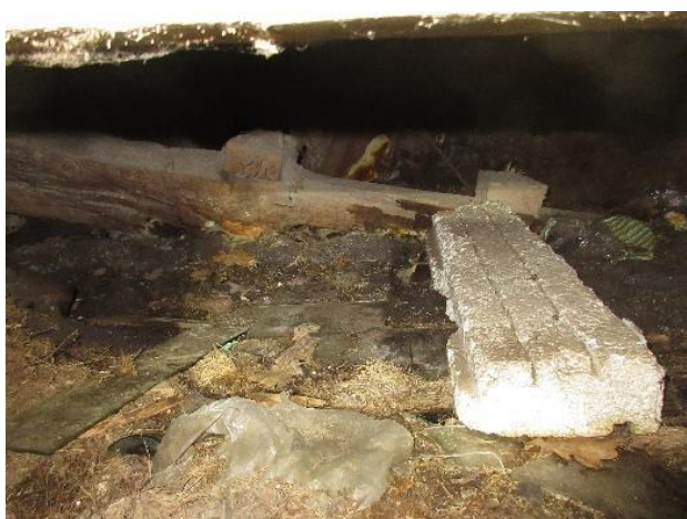
Bild 27. Krypgrunden under "kabinetti 2". Del av golvkonstruktionen har rasat ner. Vått och skräpigt på kryptrundsbottnen.
