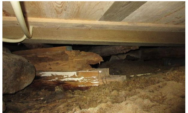
Bild 24. Gammalt virke och fyllnadsmaterial har lämnats kvar i krypgrunden.
