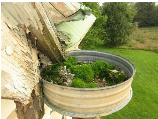
Bild 22. Stuckat stuprör vid balkongen.
