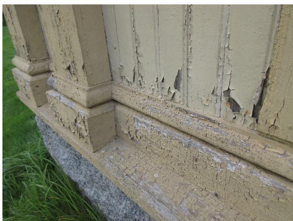
Bild 8. Färg flagar på fasaden.
