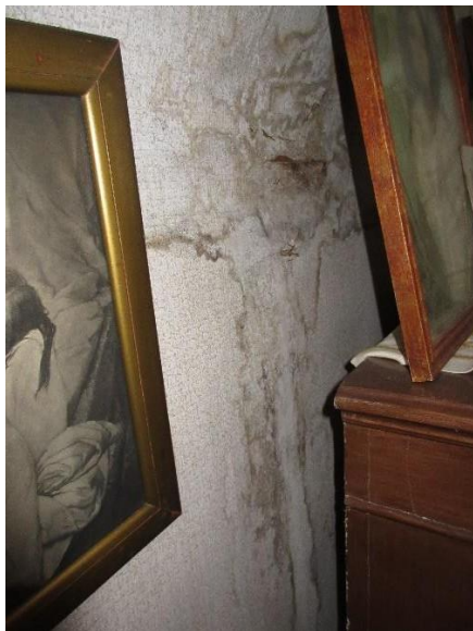
Bild 56. Vån. 2. Spår av fukt på södra ytterväggen.
