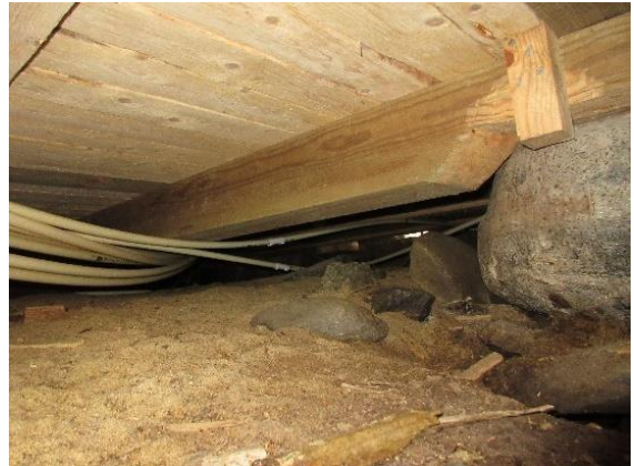
Bild 23. Krypgrunden under köket. Golvkonstruktionen har förnyats, skräp ligger kvar på botten. Mycket stor risk för mikrotillväxt i materialen, ökar risk för spridning till övriga konstruktioner.
