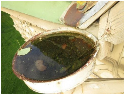
Bild 21. Stuckat stuprör vid balkongen.
