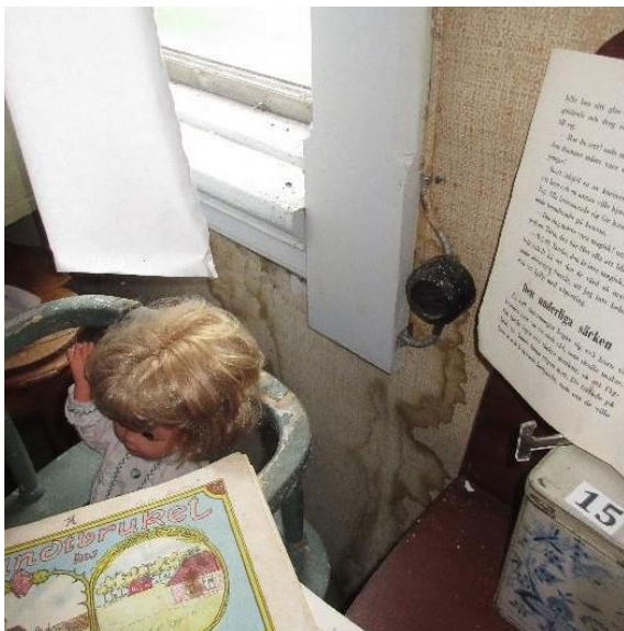
Bild 45. Kabinetti 1. Spår av fuktinträning kring fönster.
