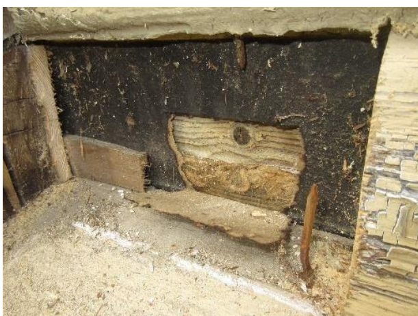
Bild x. Kontroll av fasaden. Fasadpanel-tjärpappstock. Stocken skarp vid granskningspunkten.
