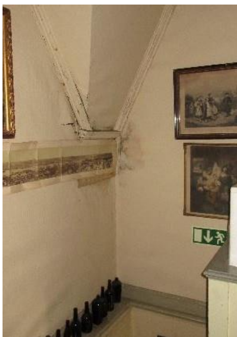
Bild 51. Spår av fukt i trapp upp till våning 2, se även bild 19.
