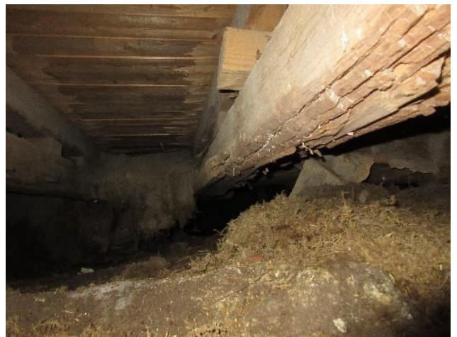
Bild 25. Golvkonstruktionen har delvis rasat ner i krypgrunden under "tarjoilu". Grava rötskador på balk.
