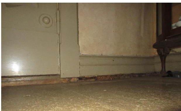
Bild 30. "Ravintola", golvet mot "kabinetti 1" har satt sig, flera centimeter mellan golvlist och golv, se också bild 29 ovan.
