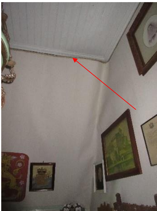
Bild 62. Spännpappret/tapeten håller på att lossa från ytterväggen.
