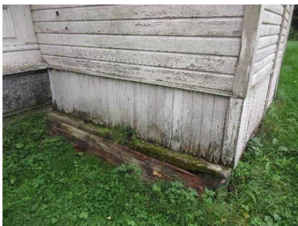
Bild 14. Pumphuset rötskadat nertill.
