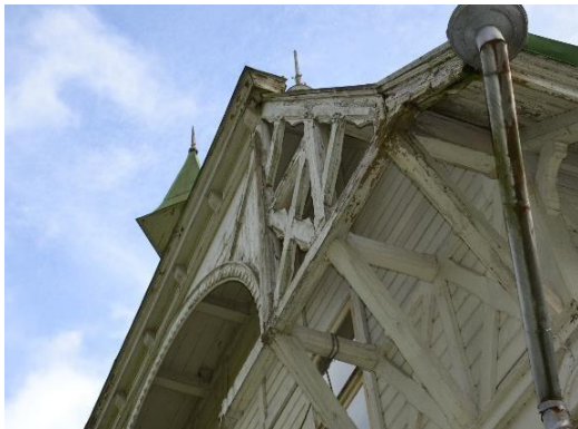
Bild 20. Fasadutsmäckningar i dåligt skick.
