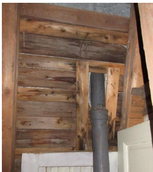
Bild 35. Våning 3. Spår av fukt kring rörgenomföring.
