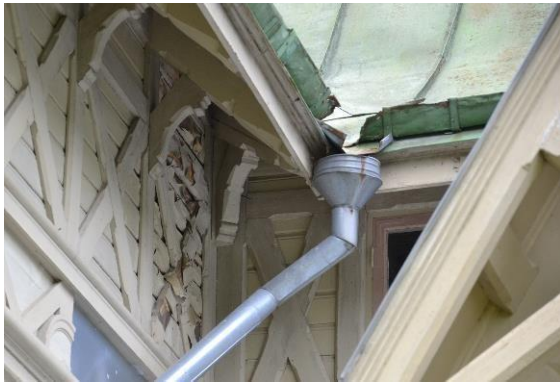
Bild 19. Färg flagar på väggen under takutskjut. Troligen har fasaden utsatts för fukt från läckage kring skorstenen ovanför. Läckaget har åtgärdats. Även spår av läckagevatten på väggen insida.
