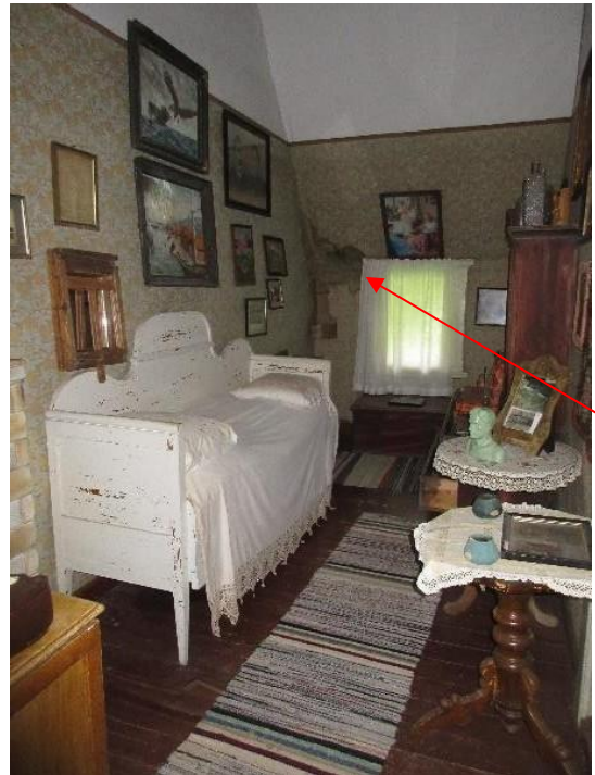
Bild 58. Vån. 2. Spår av fukt på yttervägg, eventuellt från tidigare takläckage, se bild 4.
