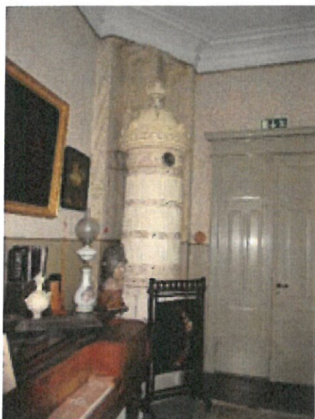
Kuva 49. Kabinetti 1. Merkkejä kosteudesta muurin ympärillä.
