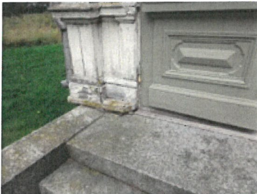
Kuva 12. Kynnyspelti puuttuu, kosteusvaurioiden riski. Kynnyspelti puuttuu joistakin ulko-ovista. Puuseinä vasten porrasta, lisääntynyt riski vaurioille.
