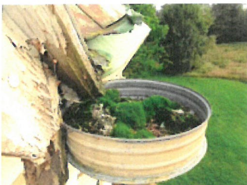
Kuva 22. Tukossa oleva juokсутorvi parvekkeella.
