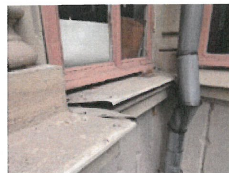
Kuva 6. Lasiveranta. ikkunapelti on irronnut ja kallistuma virheellinen. Merkkejä kosteusvaurioista sekä ulko- että sisäpuolella, puuosia osittain vaihdettu.
