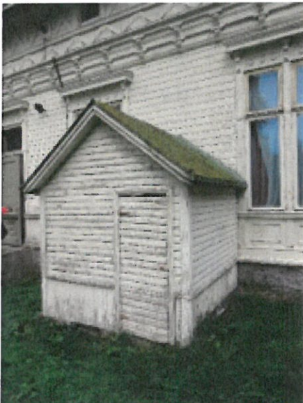
Kuva 13. Pumpputalo keittiön ulkopuolella on rakennettu myöhemmin, ei ole merkintää pohjapiirustuksessa.
