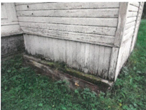
Kuva 14. Pumpputalo lahonnut alhaalta.
