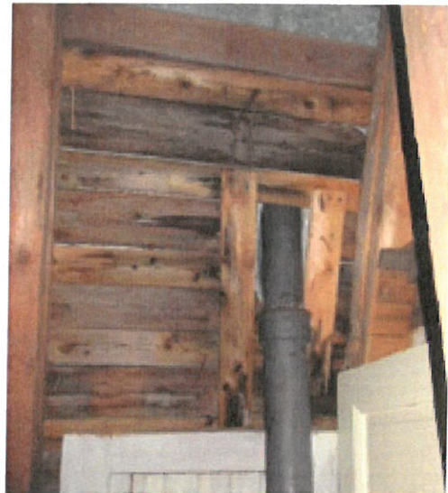
Kuva 35. 3. kerros. Jälkiä kosteudesta putkien läpiviennissä.
