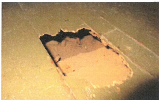
Kuva 43. Ruokasalin syöty lattialankku.
