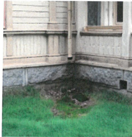
Kuva 10. Sadeveden ohjaus puuttuu. Juoksutorvi johtaa veden kivijalkaan, mikä lisää rakennelmien kosteuskuormitusta ja sadevesi hakeutuu rakennuksen perusteisiin.
