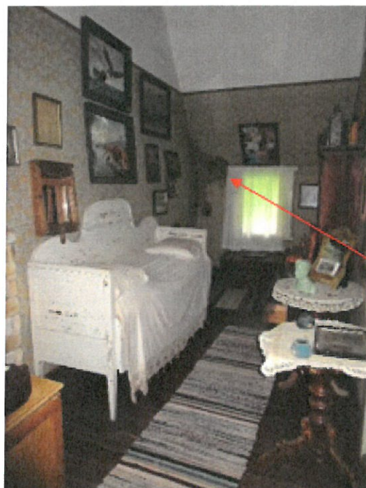
Kuva 58. 2. kerros. Ulkoseinässä merkkejä kosteudesta, mahdollisesti johtuen aikaisemmista vuodoista katolla, kts. kuva 4.
