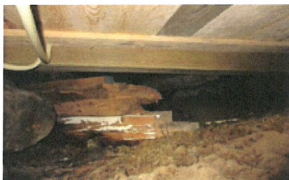
Kuva 24. Ryömintätilaan jäänyt vanhaa puuta ja täytemateriaalia.
