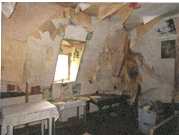
Kuva 33. 3. kerros, pohjoispäädyn huone. Tapetit irttoilevat seinistä, luultavasti raa'asta ilmasta ja kosteudesta johtuen, sillä rakennuksessa ei ole lämmitysjärjestelmää.
