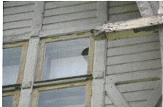
Kuva 15. Esimerkki rikkiäisestä ikkunasta, esiintyi muutamissa paikoissa.]
