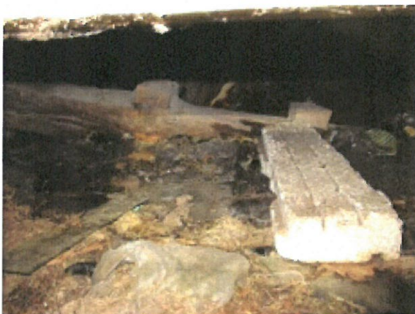
Kuva 27. "kabinetti 2:n" alla oleva perusta. Osa lattiarakenteista on pudonnut alas. Märkää ja roskaista perustan pohjalla.
