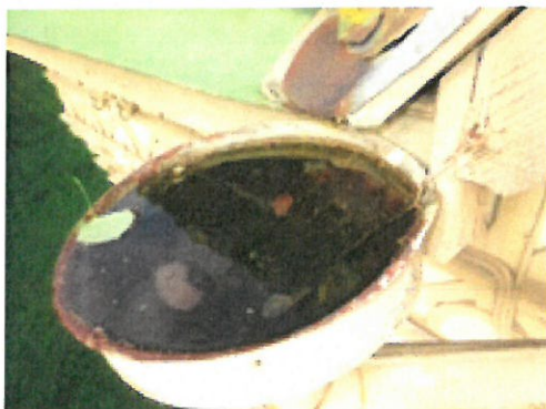
Kuva 21. Tukossa oleva juokсутorvi parvekkeella.
