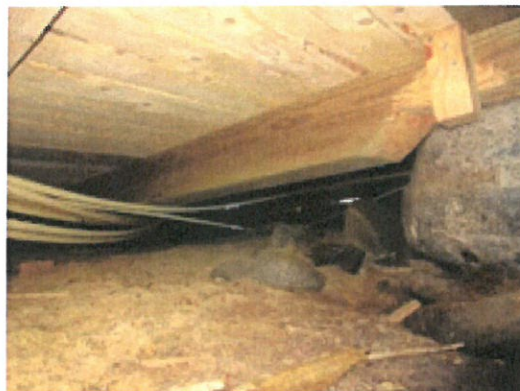
Kuva 23. Keittiön alla oleva ryömintätila. Lattiarakennelma on uusittu, roskaa jäänyt tuulettuvaan alapohjaan. Erittäin suuri riski mikrobikasvuun materiaaleissa ja leviämishäke rakenteisiin.
