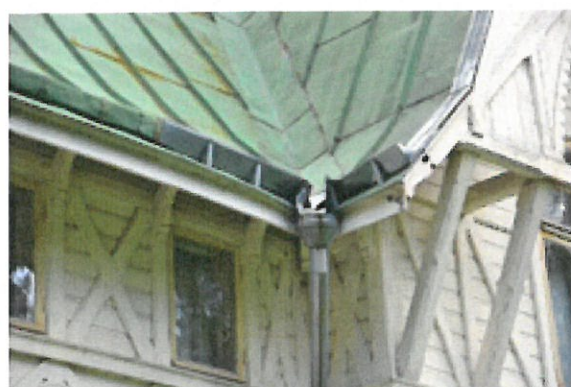
Kuva 5. ylhäällä kohta A, jalkarännit ja juoksutorvet on osittain uusittu. Tikan hakkuujälkiä, lahonneita puuosia, lohkoileva väri.
