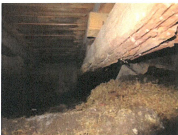
Kuva 25. Lattiarakenne on osittain pudonnut alas perustaan kohdassa "tarjoilu". Vakavia lahovaurioita palkissa.
