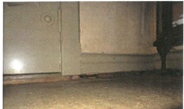
Kuva 30. "Ravintola", lattia kohti "kabinetti 1" on vajonnut, lattialistan ja lattian välistä, kts. myös yllä oleva kuva 29.
