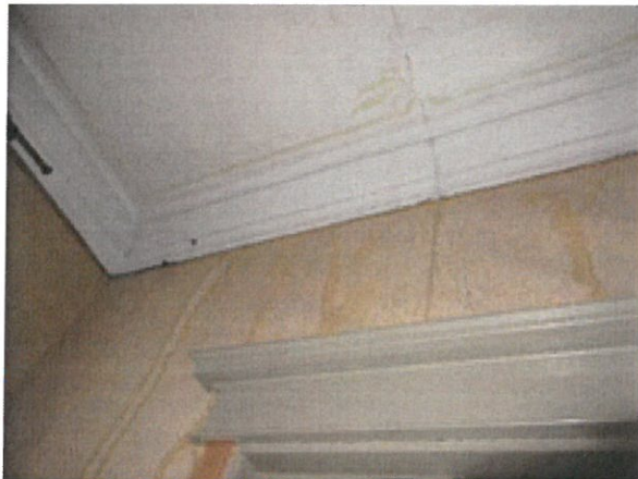
Kuva 45. Kosteutta oven yläpuolella kohdassa "kabinetti 1". Mahdollisesti katon vuotokohdan kautta.
