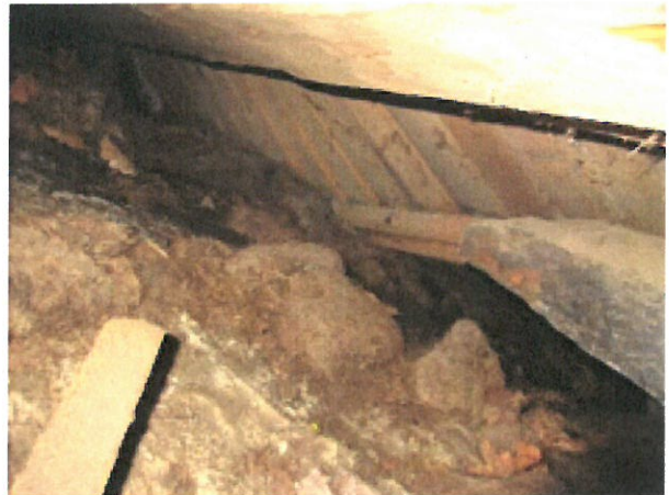
Kuva 29. Lattiarakenteet ovat paikoittain pudonneet alas tuulettuvaan alapohjaan kohdassa "ravintola".
