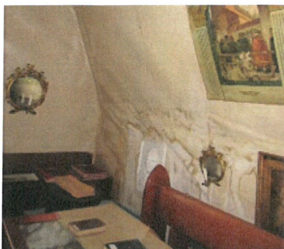
Kuva 55. 2. kerros. Seinässä merkkejä kosteudesta, mahdollisesti johtuen aikaisemmista vuodoista katolla, kts. kuva 4.
