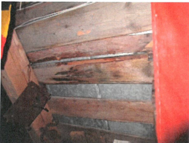
Kuva 34. 3. kerros. Jälkiä kosteudesta kattolyhdyn ympärillä.
