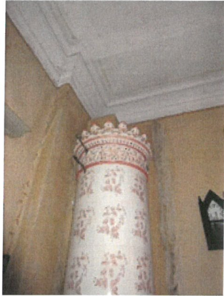
Kuva 46. Kabinetti 1. Merkkejä kosteudesta muurin ympärillä.
