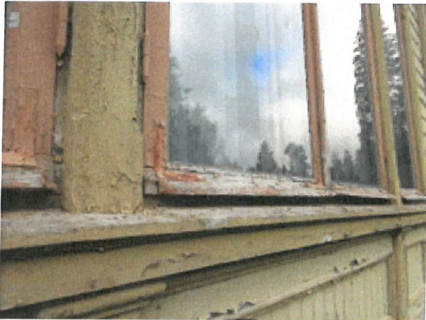
Kuva 7. Ikkunakarmit vaihtelevassa kunnossa. Maaliväri lohkoilee sekä ikkunakarmissa, että seinässä.
