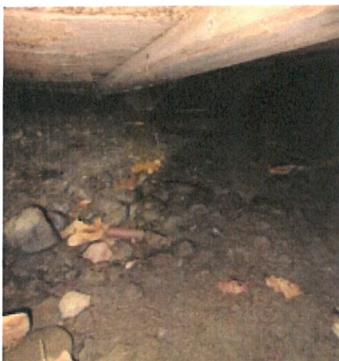
Kuva 28. "kabinetti 1:n" alla oleva tuulettuva alapohja. Kosteaa, maan pinta paikoittain korkea, lattiarakennelma on paikoittain romahtanut alas tuulettavaan alapohjaan.
