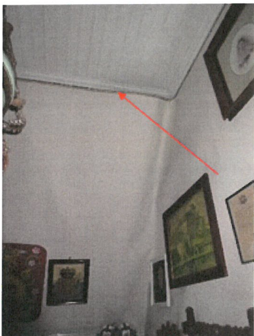
Kuva 62. Pinkopahviitapetit ovat irtoamassa ulkoseinästä.
