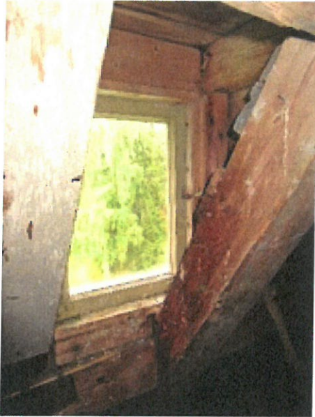
Kuva 32. Lintujen ulosteita ja pieniä jälkiä sadevedestä kattolyhtyjen ympärillä.
