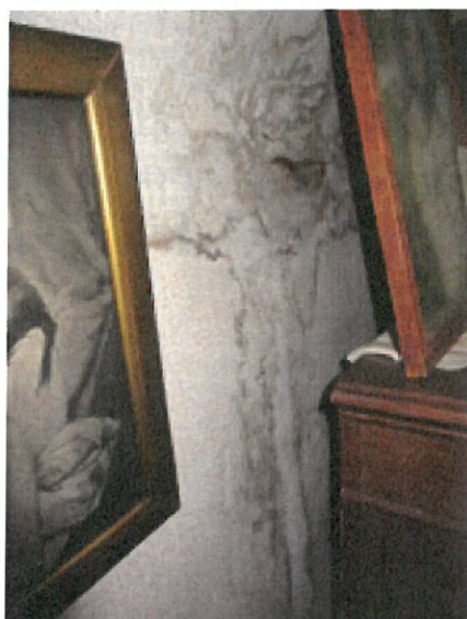
Kuva 56. 2. kerros. Eteläisellä ulkoseinällä merkkejä kosteudesta.
