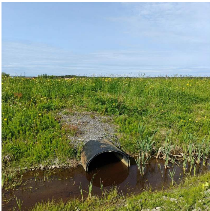
Kuva 2. Valtatien alise kulkeva 800 mm rumpuputki.
