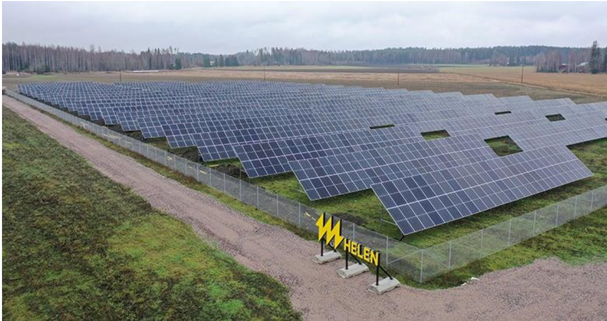
KUVA 4 ESIMERKKIKUVA PANEELISTA JA SUOJA-AIDASTA. KUVA: HELEN OY
