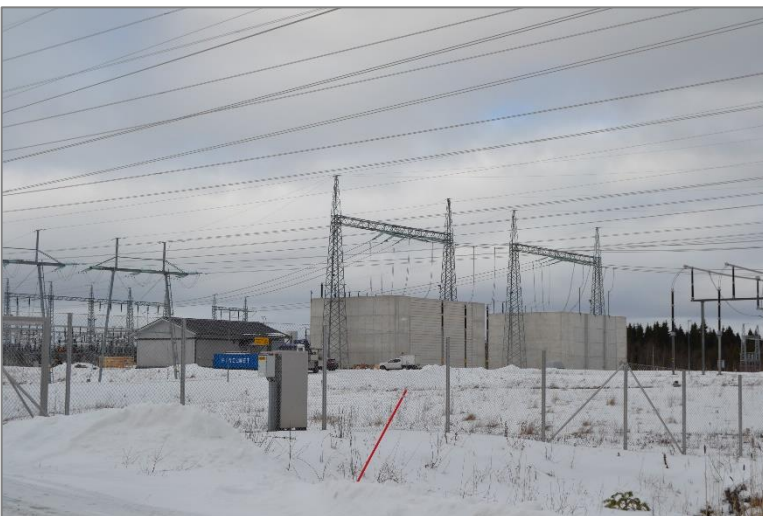
Kuva 18. Fingrid Oyj:n sähköasema (kohde 8) kuvattuna kaakosta. Vasemmalla näkyvä harjakattoinen valvomorakennus valmistui 2014.
