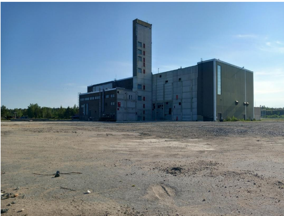
Kuva 4. Vanhassa voimalaitosrakennuksessa on paljon koloja ja avoimia aukkoja, joista lintu pääsevät lentämään sisälle.
